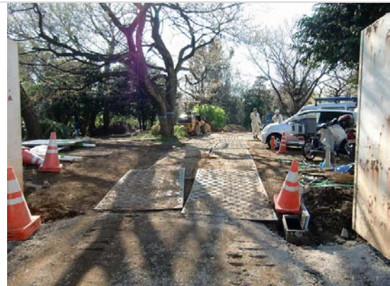
2012.04.04 御殿坂上方部、工事用通用門付近【工事中】工事車両のために鉄板が敷かれ、地面の損傷著しい。
