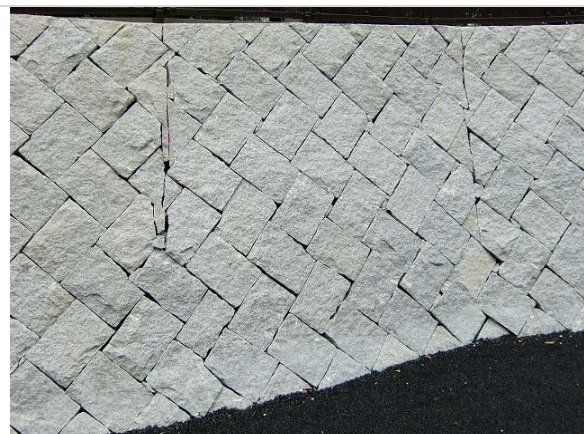
2012.04.11 御殿坂の新しい塀の石組【工事終了後】完成した塀にはひび割れたつなぎ目が5-6か所ある。
